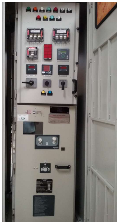
11KV ICOG Panel
